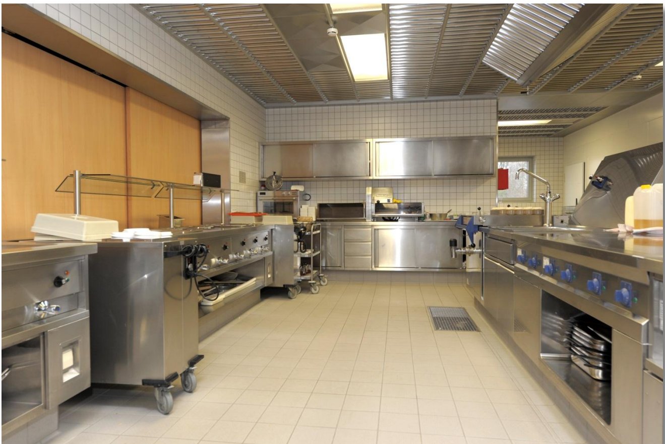
VERSCHLISSBARE AUSGABE LINKS, KOCHBLOCK RECHTS, BROTSCHNEIDEBEREICH IM HINTERGRUND
