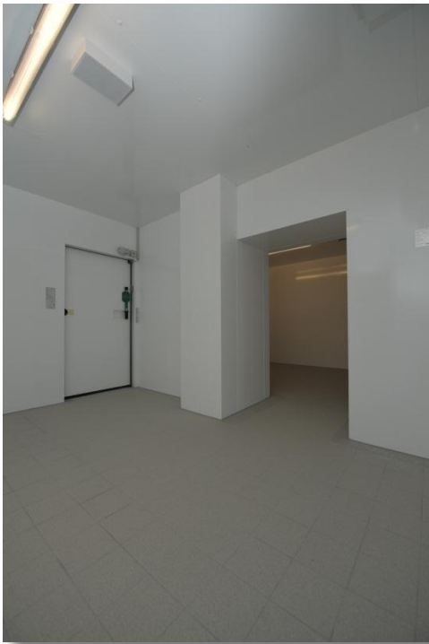
KÜHLRAUM-TUNNEL DURCH BRANDSCHUTZWAND
