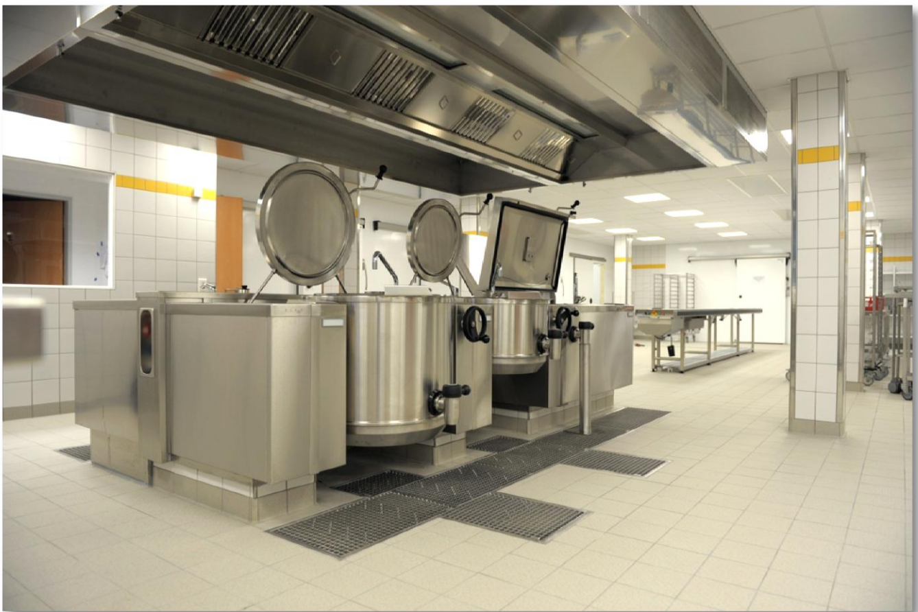
KOCHBLOCK MIT LÜFTUNGSHAUBE
